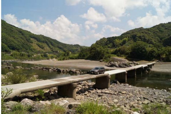
車両1台が通るのにぎりぎりの幅。 白い部分は、崩落して補修した部分
